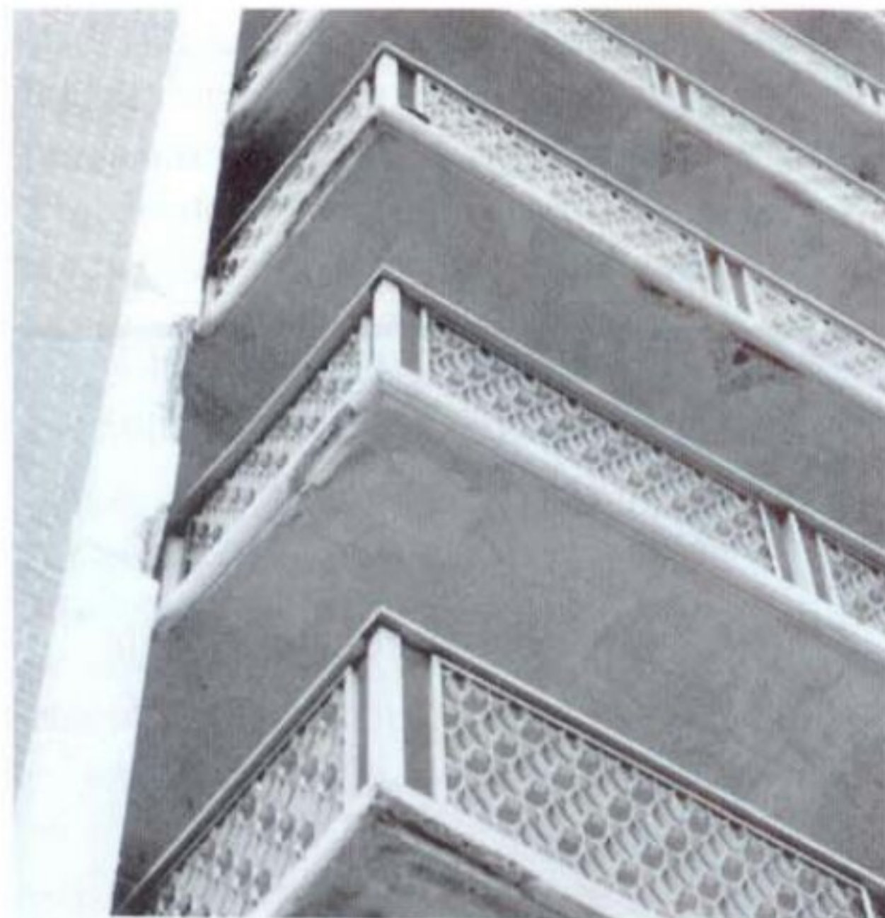
Desplacamento nas bordas das varandas
